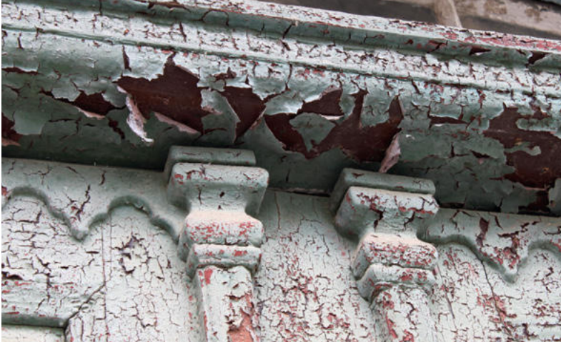
2 | Farbrisse in der Fassade eines alten Wohnhauses
